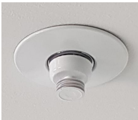
Kuva 1. Sprinklerisuutin asennettuna kattoon
