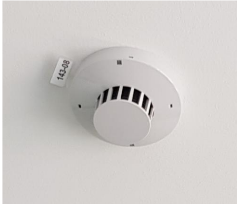
Kuva 3. Paloilmoitinlaitteiston paloilmalaisin asennettuna kattoon
